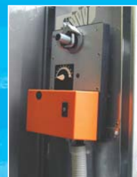
Автоматический привод управления вентиляционными жалюзи
