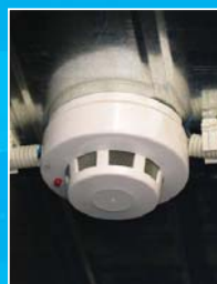
Датчик системы пожарной сигнализации
