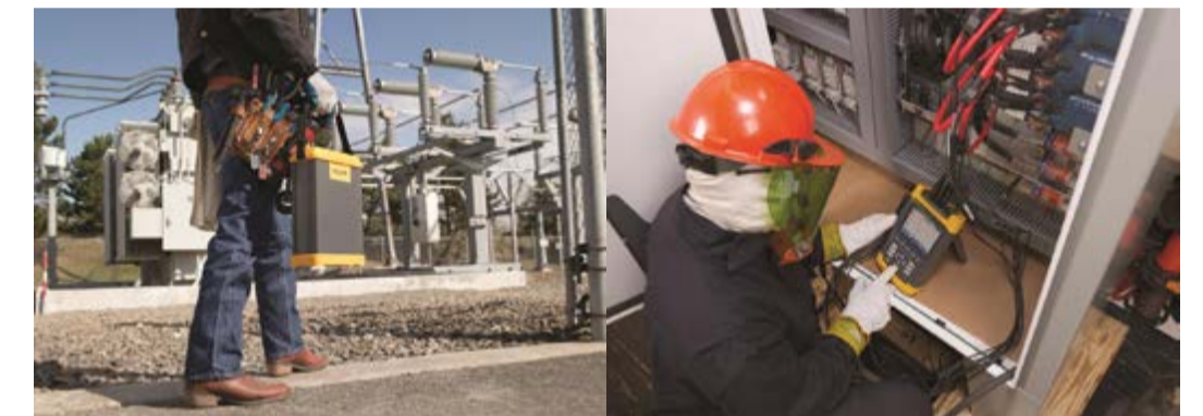
Рис. 6. Для проверки и измерения величины коэффициента мощности, переходных процессов, провалов напряжения, гармоник и других параметров качества электроэнергии, которые могут привести к серьезным повреждениям трансформаторов, а так же другого оборудования, важно контролировать параметры качества электроэнергии с использованием измерительных приборов в соответствии с требованиями международных стандартов, например, IEC 61000-4-30.
