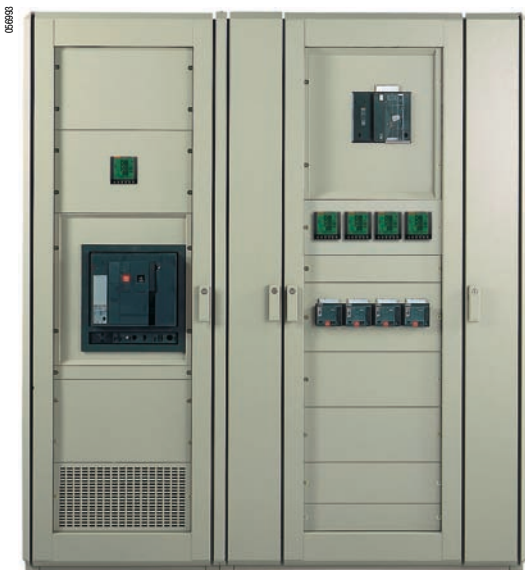
Главный распределительный щит
