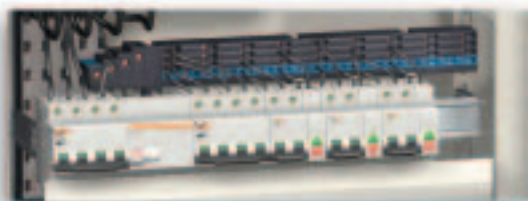
Пример подключения посредством распределительного блока Multiclip на 80 А
