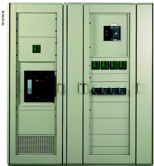
Главный распределительный щит низкого напряжения
