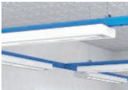
Применение кабельных лотков для монтажа светильников
