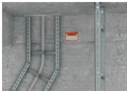
Реализация изменения направления кабельных лотков лестничного типа SLM.
