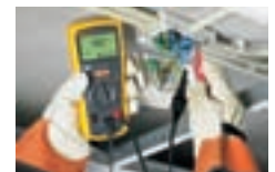
Проверка проводки в небольшой распределительной коробке – все в одной точке
