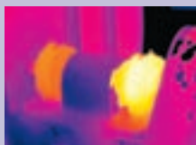
Перегрев крышки подшипника
