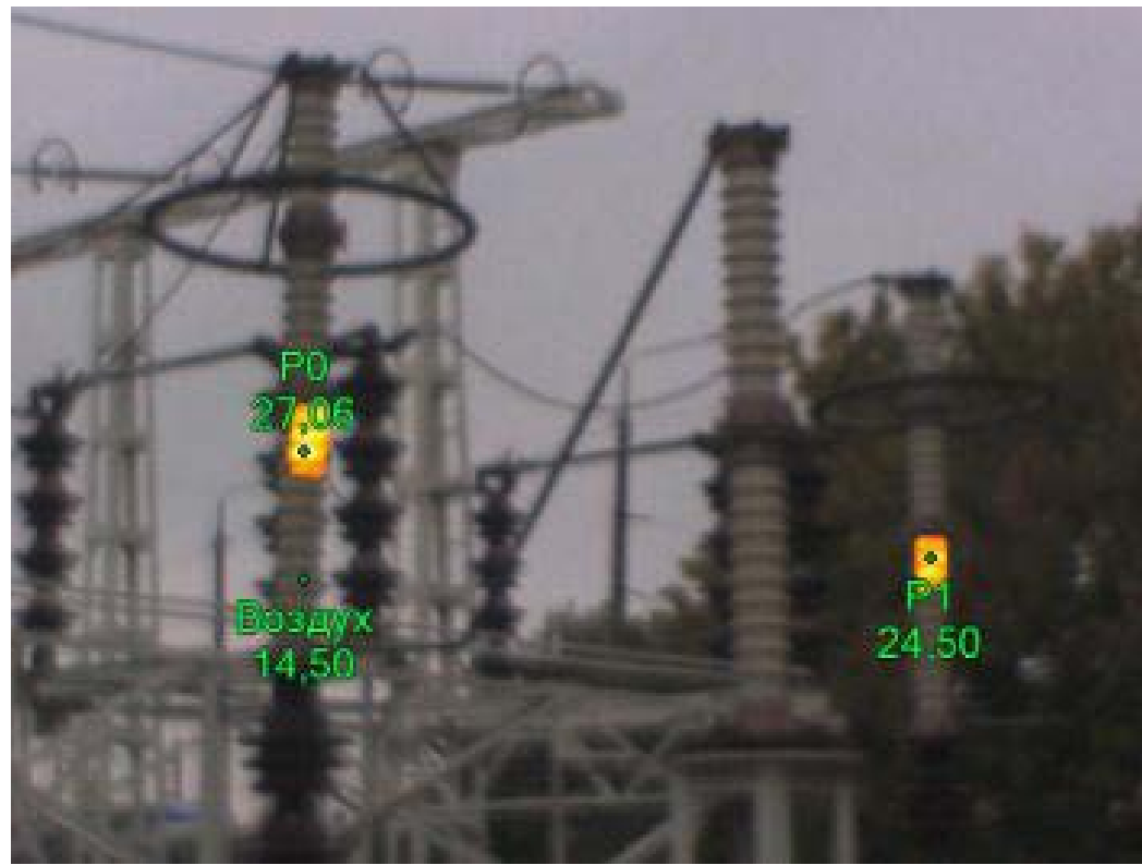
Рис. 7. Дефекты изоляторов разрядников, проявляющиеся за счет тока утечки на землю. В подобных случаях даже незначительные разности температур величиной 3-5 °С уже могут указывать на наличие серьезных проблем с изоляцией разрядника от земли, что влияет на его работу и на безопасность всей подстанции.
