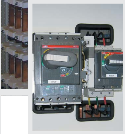
••• Рис. 7.2. Автоматические выключатели ШЛ на монтажной панели
