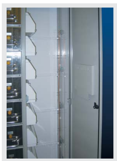
••• Рис. 8.4. Коробки выводов в кабельном шкафу НКУ «Ассоль»
