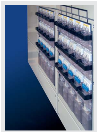
••• Рис. 7.4. Линейные шкафы с держателями предохранителей
