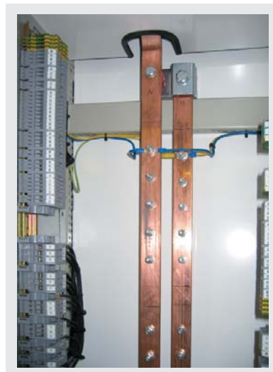
••• Рис. 7.5. Клеммные ряды в кабельном шкафу НКУ
