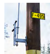
Kraftledningsstolpe med skylt H80 på fäste H80-1
