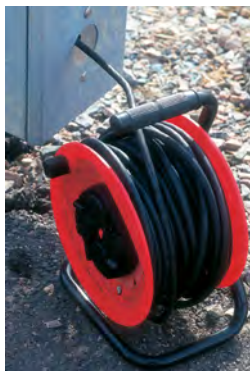
Revolvertätning på skåpets gavel används för bl.a. tillfälliga uttag
