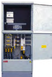
Kapsling med monterad fördelning och kWh-mätning
