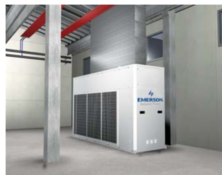
Liebert HIROSS HPC-R в помещении завода
