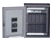
Шкаф батарей резервного питания
