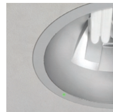
Светодиодный индикатор показывает заряд аварийных батарей.
