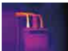
Неисправное соединение и внутреннее повреждение
