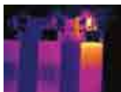
Внутренние повреждения предохранителя
