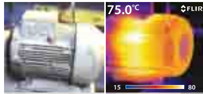
Двигатель: внутренняя неисправность проводки
