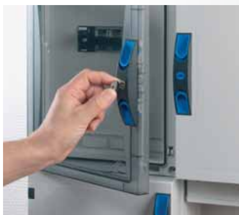
Bedienung der Geräte hinter der Tür mit Berührungsschutz
