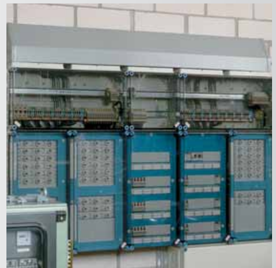
Abdeckung der Kabeleinführung mit Rangier-Kanal.
