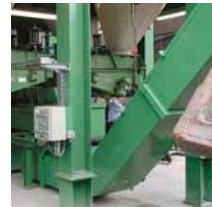
■ Kratzerförderer unter einer Bunkeranlage für Aluminium-Späne
