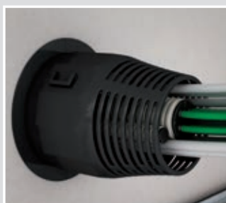
Mischbelegung von Leitungen und Rohren.
