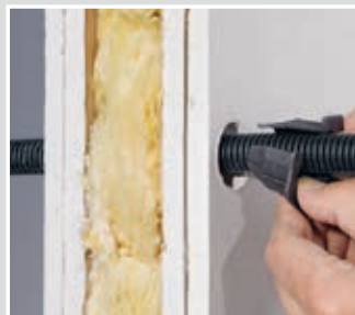
Für die Montage das Schott seitlich öffnen und über das Rohr schieben.
