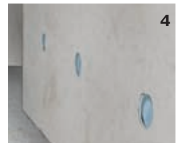
4 Se pueden instalar luminarias o altavoces.
