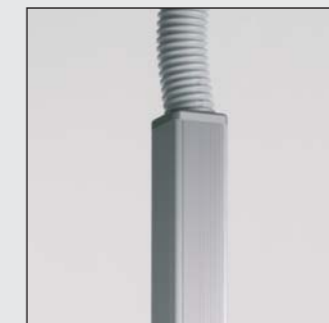
Кабели выходят из потолка внутри гофрированного шланга.
