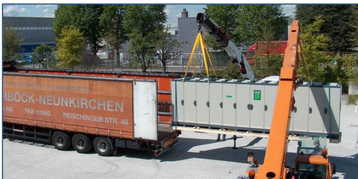
Operazioni di carico di un Discovery da 2000kVA \pm 20\%
