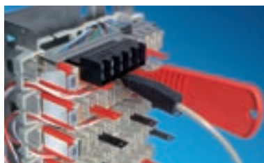
Кроссировка выполняется с установленной защитой
