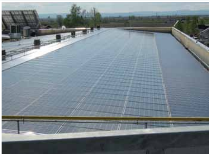
Borgo d'Ale (VC) Potenza impianto: 80 kWp EPC Contractor: Soland Energia Fotovoltaica S.r.l.
