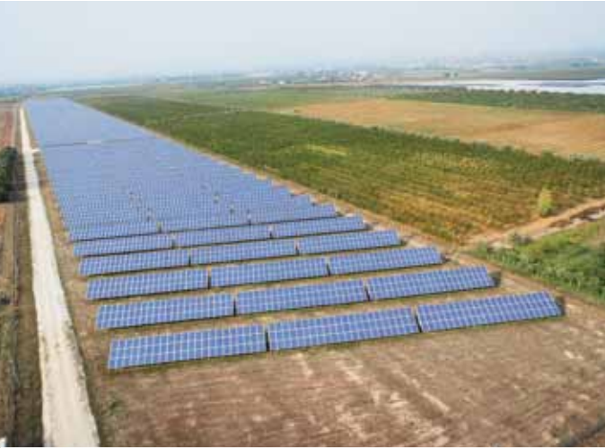
Aprilia (LT) Potenza impianto: 3.200 kWp EPC Contractor: Siemens S.p.A. - Energy Sector
