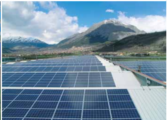
Celano (AQ) Potenza impianto: 400 kWp EPC Contractor: Enerray S.p.A.
