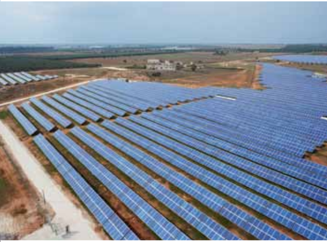
Lequile (LE) Potenza impianto: 5.000 kWp EPC Contractor: Siemens S.p.A. - Energy Sector
