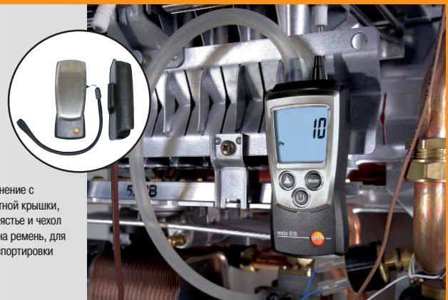
Измерение дифференциального давления в системах газового отопления
