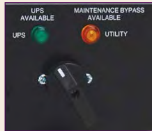
Interruptor de Derivación para Mantenimiento (Switch de Transferencia Manual)
