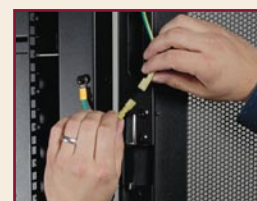
Cables de liberación rápida a tierra
