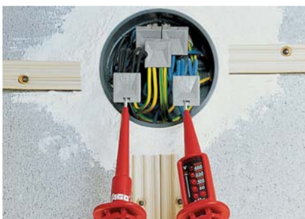
Контроль напряжения на клеммах в распределительной коробке
