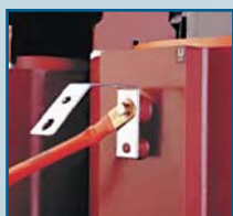
Клеммы выводов высокого напряжения
