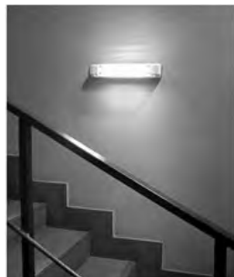
аварийное освещение путей эвакуации
