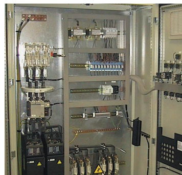
Панель управления мощностью с двумя тиристорами
