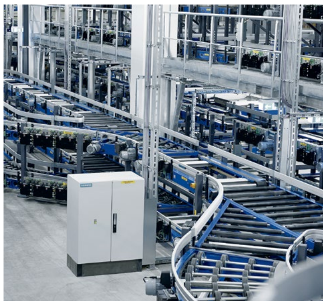
Децентрализованно установленные шкафы CM обеспечивают защиту систем управления Siemens для установки обработки багажа.
