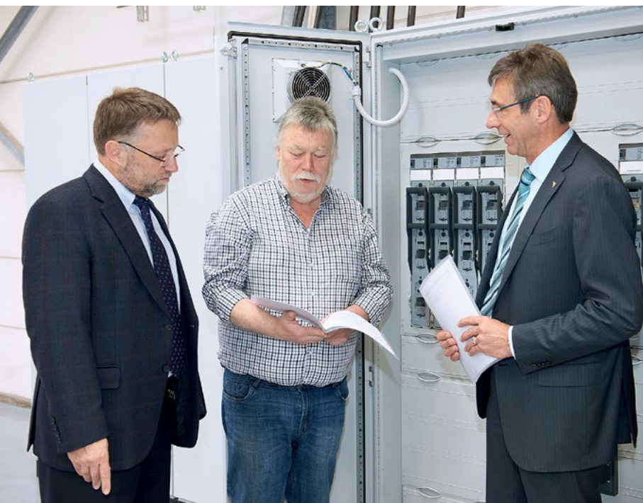
Вольфганг Эмер (специалист Rittal), Матиас Кракрюгге (Energietechnik Breckerfeld) и Уве Брассельман (владелец deller plastics) с инсталляционным распределителем ISV компании Rittal, который отличается простотой монтажа.
