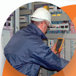
Оборудование, обеспечивающее или улучшающее распределение электроэнергии до точки конечного потребления
