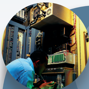
Оборудование для преобразования энергии
