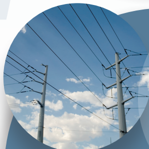
Оборудование, обеспечивающее передачу электроэнергии от места генерации по распределительным сетям
