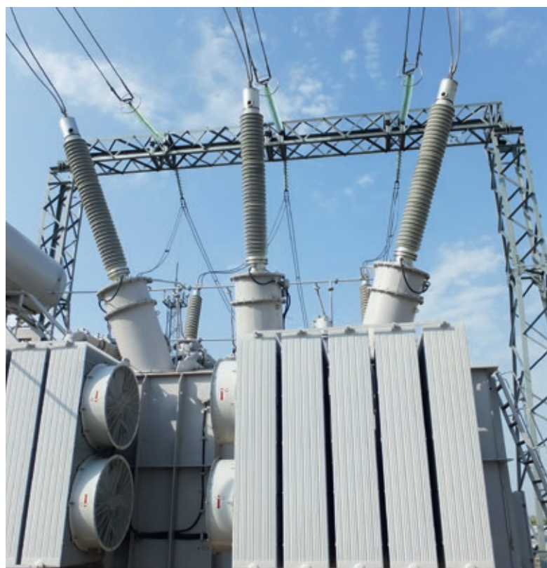
Вводы 330 кВ компании «Изолятор» на трансформаторе магистральных электрических сетей
