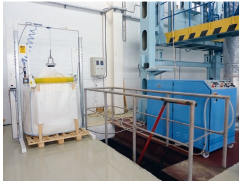
Рис. 21. Установка для дегазации и дозирования компрессионного геля на заводе «Изолятор»
