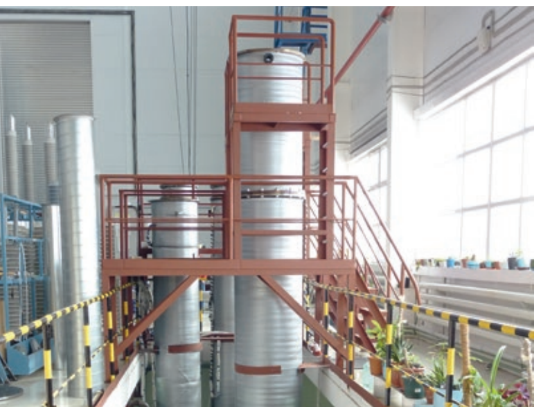
Рис. 32. Камеры термовакuumной сушки изоляции 500–1150 кВ на заводе «Изолятор»
