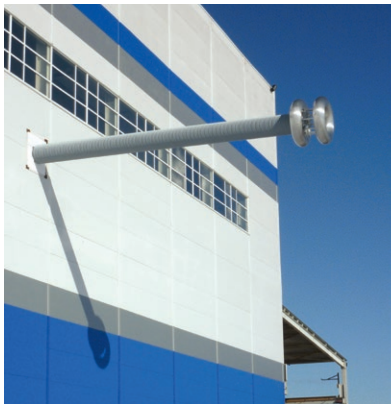
Линейный ввод 820 кВ постоянного тока в испытательном центре компании «Изолятор»
