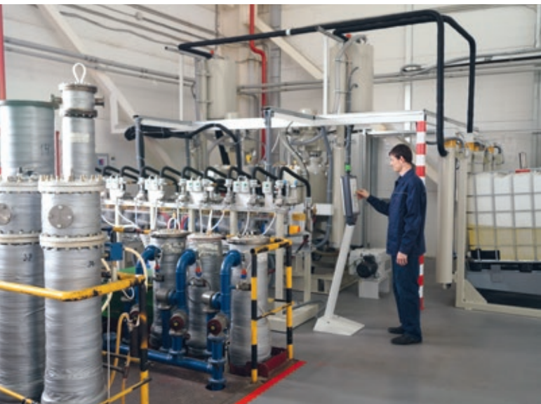
Рис. 18. Машина Hubers для вакуумной пропитки изоляции на заводе «Изолятор»
