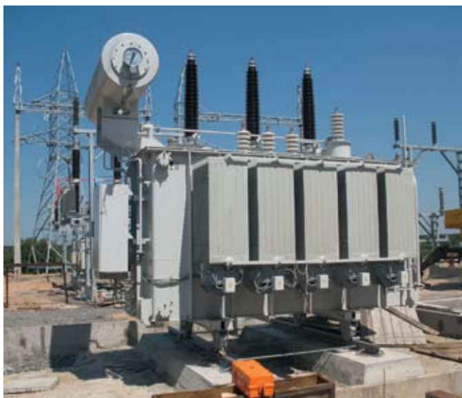
Трансформатор ТДН-10000/110 VI, ПС «Лебедевка» Жлобин, Республика Беларусь, 2010
