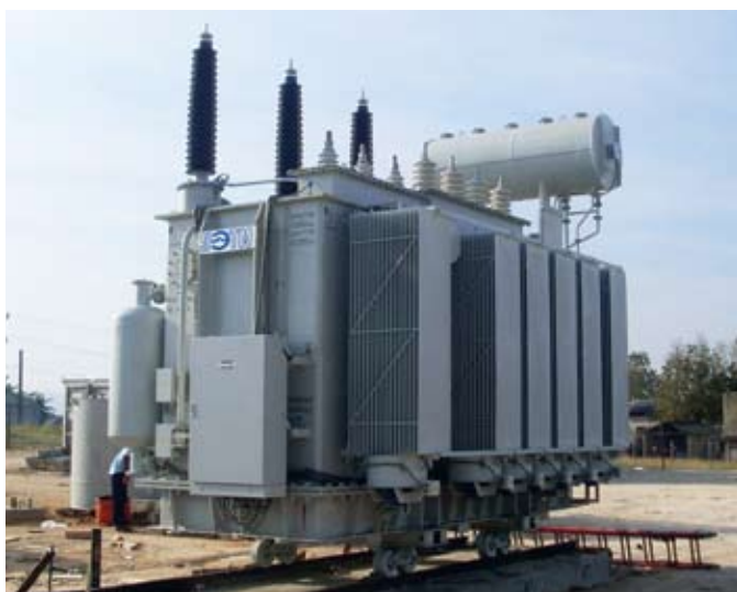
Трансформатор ТДТН-25000/110, Республика Куба
