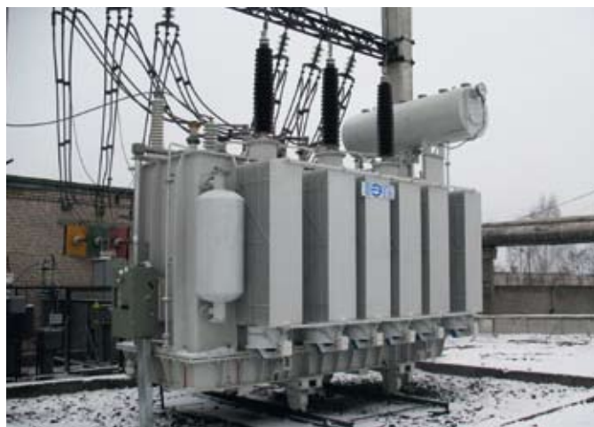
Трансформатор ТРДН-40000/110, ПС Гродно, Беларусь
