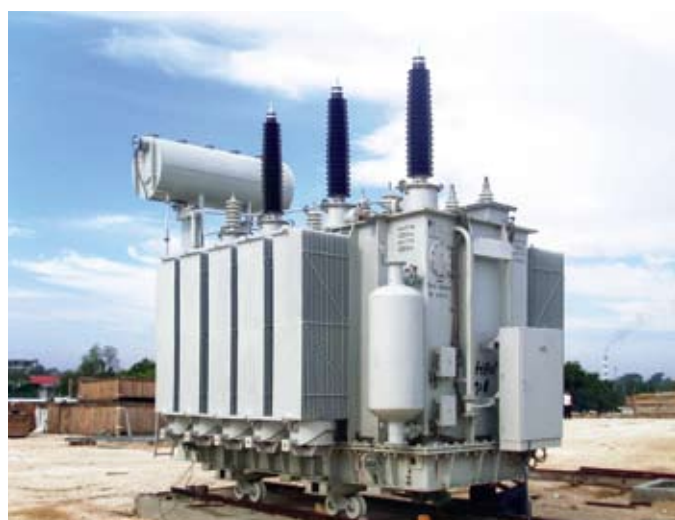
Трансформатор ТДТН-25000/110 TI ПС «Симфуэгос», Куба, 2010
