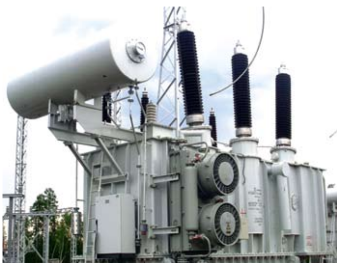
Автотрансформатор АТДЦТН-63000/220 УХЛ1 ПС «Сунтар», Республика Саха, Якутия, 2010
