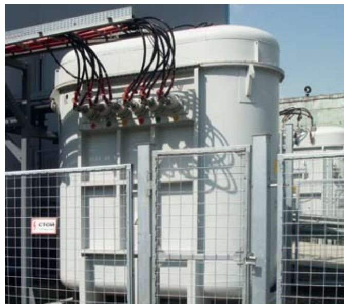
Сухой трансформатор ТРСЦДПЧ-16000/10 УХЛ1 на ГТ ТЭЦ в г. Екатеринбурге, 2009
