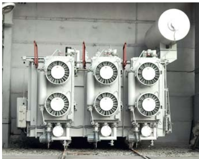
Трансформатор ТАЦНПФ-40000/10, Мончегорск, Россия
