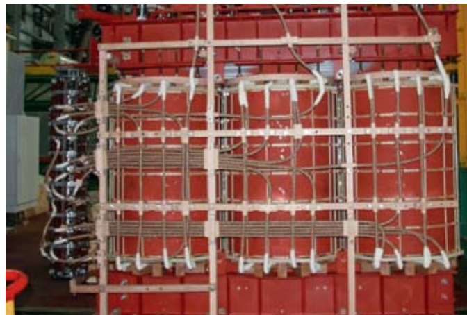
Активная часть трансформатора ТДПУ-12500/10
