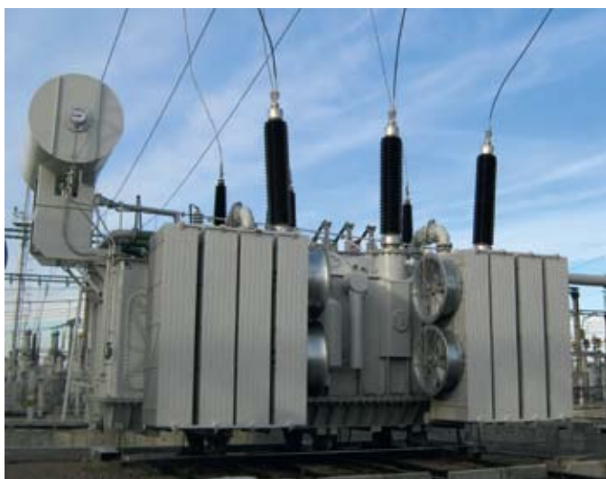
Автотрансформатор АТЦЛТН-125000/220/110, Казахстан
