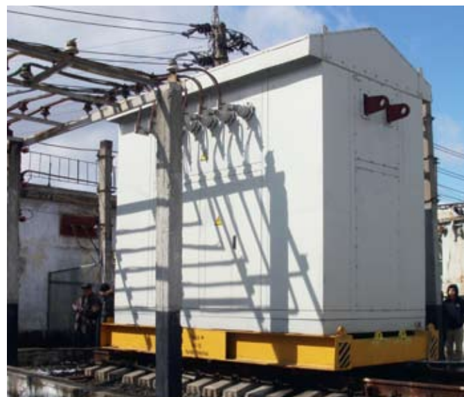
Сухой трансформатор ТРСЭП-12500/10 Ж УХЛ1 на ПС «Шарташ» Свердловской ж/д, 2008
