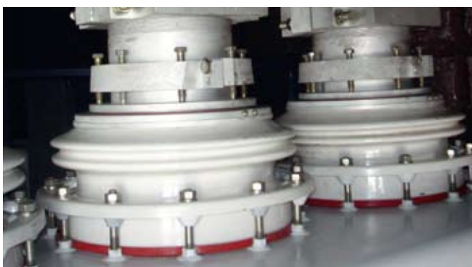
Вводы вентиляющей обмотки преобразовательного трансформатора
