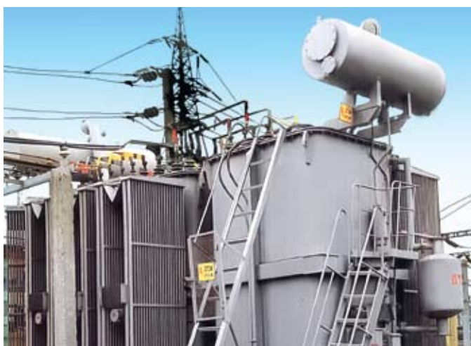
Масляный преобразовательный трансформатор ТРДП-16000/10 в комплекте с управляемым реактором РТДП-6300/10 ЖУ1
