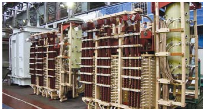
Активная часть преобразовательного трансформатора ТДНП-12500/10 VI
