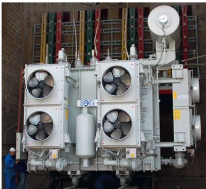
Трансформатор ТАЦНП-25000/10, Алюминиевый завод, Египет
