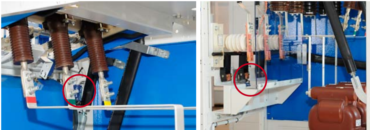
Концевые выключатели на приводах разъединителей и приводах заземлителей
