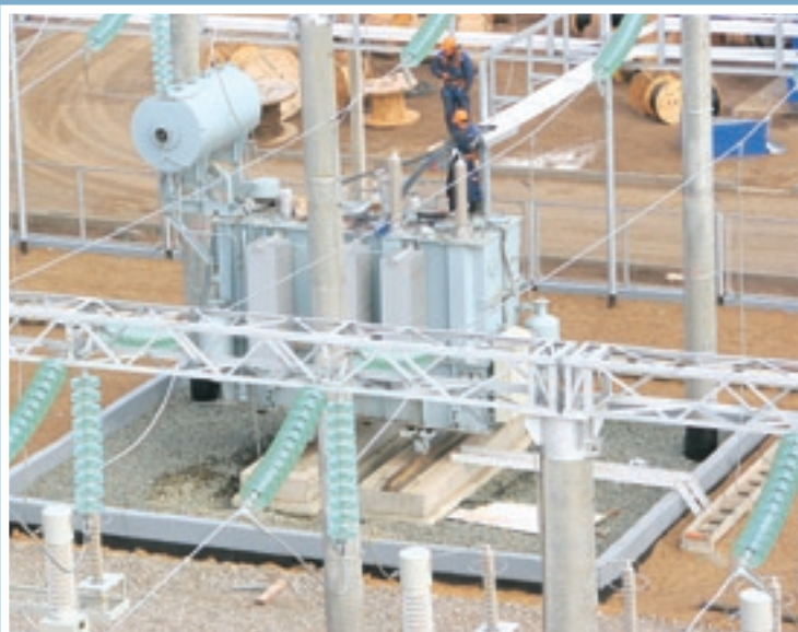
ОРУ 110кВ ГТС 54, г. Уральск 110kV Switchyard of GTPS 54MVA, Uralsk city
