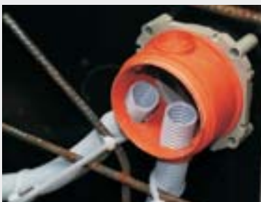
Корпус KBT и подведенные в него трубы.
