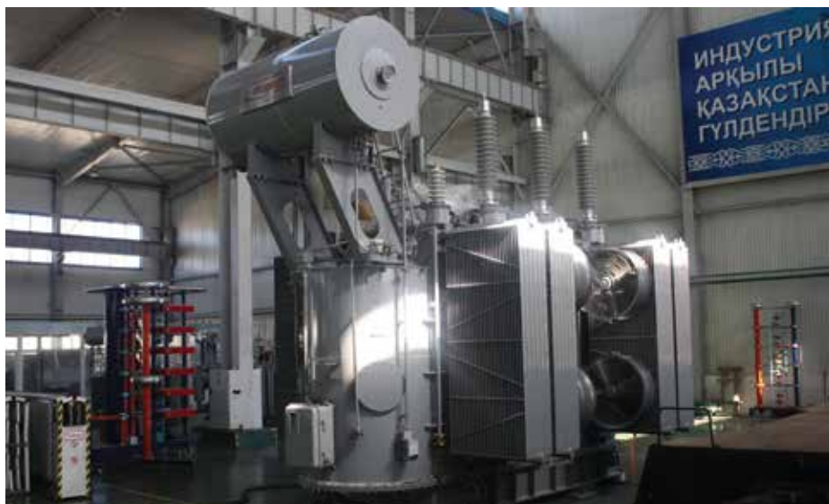
Трансформатор напряжением 110/35/10 кВ мощностью 80 МВ·А
