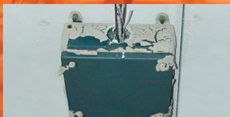
Ответвительные коробки с подключенными кабелями после теста
