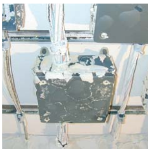
Ответвительная коробка с подключенными кабелями после испытаний..
