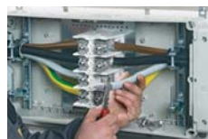
Проводники должны быть тщательно зачищены от окислов
