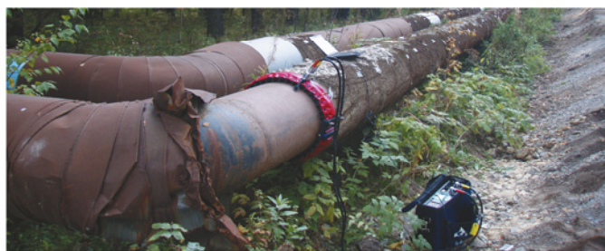
Рис. 8 Оценка состояния теплотрасс на наличие коррозии и мелких утечек под изоляцией
