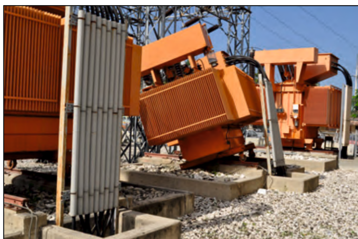
Рисунок 2.1б Опасность землетрясения для электрических трансформаторов (изображения из веб-страницы Агентства чрезвычайных ситуаций www.fema.gov )
