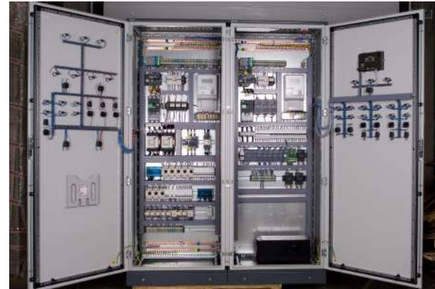
➤ Шкаф управления насосной станцией
