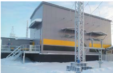
Закрытое распределительное устройство с КРУЭ-СЭЩ 110 кВ
