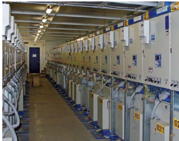
КРУ в модульном здании
