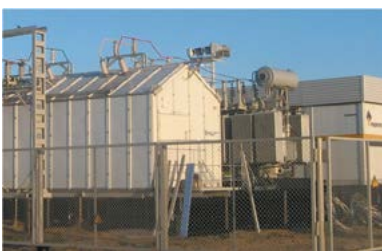
Открытое распределительное устройство ОРУ-СЭЩ 35/6 кВ
