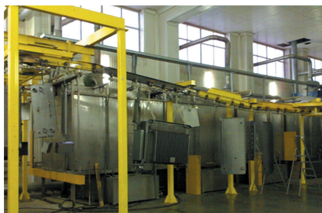
Участок по сушке баков трансформаторов
