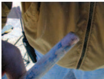
Штырь заземления с медным покрытием толщиной 254 мкм, извлеченный из грунта (суглинок) после 10 лет
