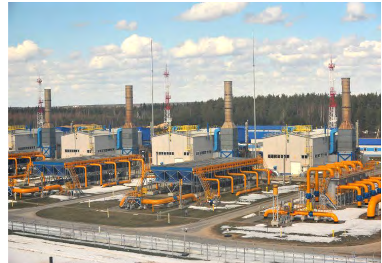
КС «Шексинская». Газопровод «Грязовец-Выборг»
