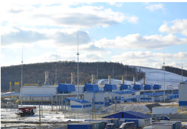
Компрессорная станция «Русская». Южный поток
