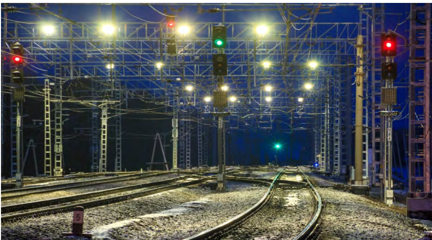
Освещение путей с помощью ригельных прожекторов
