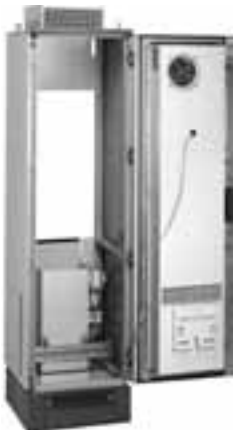
Комплектный шкаф VV3 A9 544
