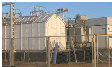
Закрытое распределительное устройство ЗРУ-СЭЩ 35/6 кВ
