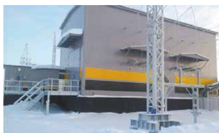
Закрытое распределительное устройство с КРУЭ-СЭЩ 110 кВ
