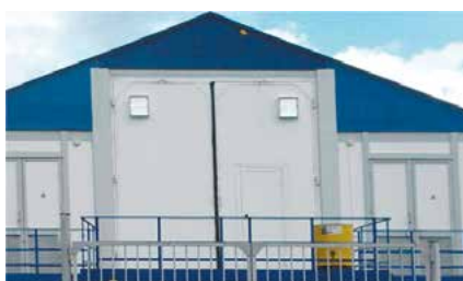
Закрытое распределительное устройство ЗРУ-СЭЩ 20/6 (6/20) кВ
